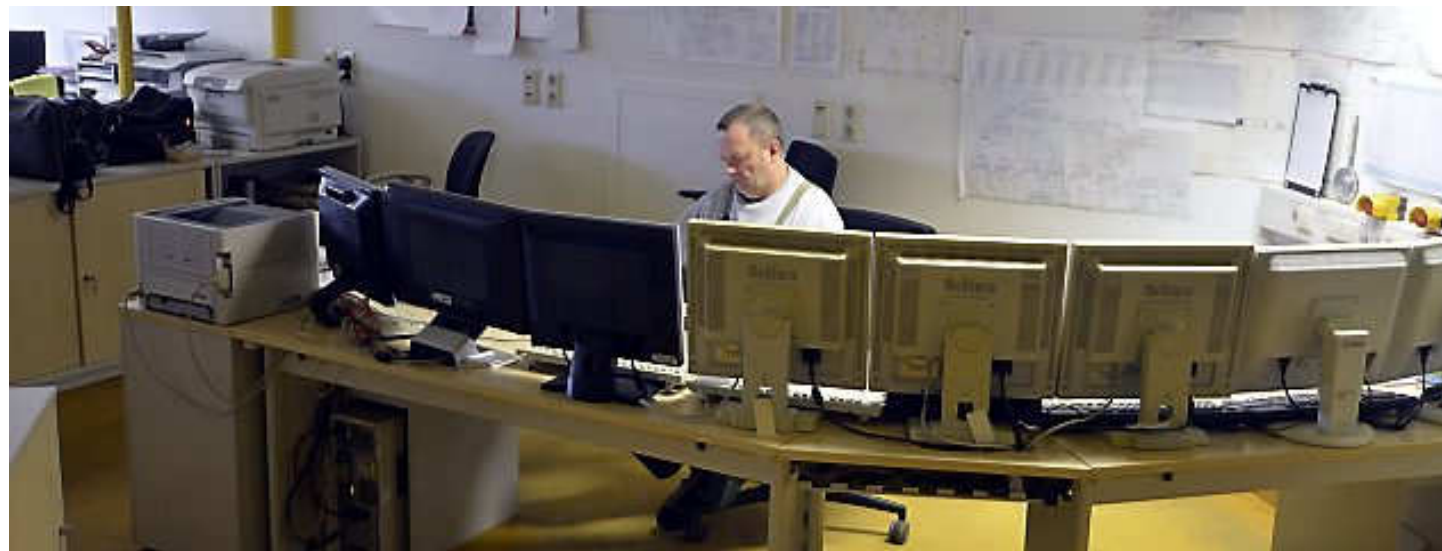
Blick in die Schaltzentrale des Bio-Kraftwerks Schkölen. Archiv-Foto: Dieter Urban
